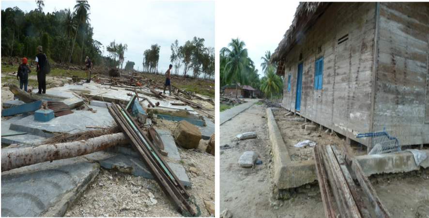
Gambar 19. Kerusakan pemukiman hancur total di Dusun Tumalei, kiri dan kerusakan bangunan pemukiman sebagian, tampak bangunan bergeser dari pondasinya, kanan. Foto: GITST.
