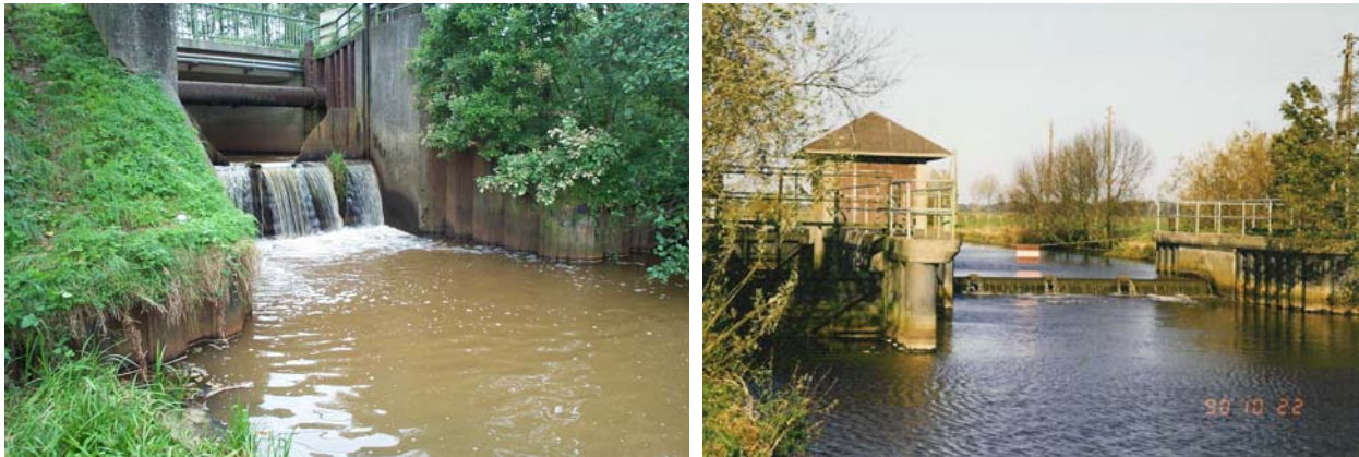
Abbildung 3-13: Wehr Giehlermühlen (links), Hartheckel – Schleuse (rechts)
