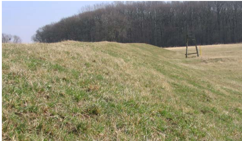
Abbildung 4-22: Vertiefungen auf einem Deich
