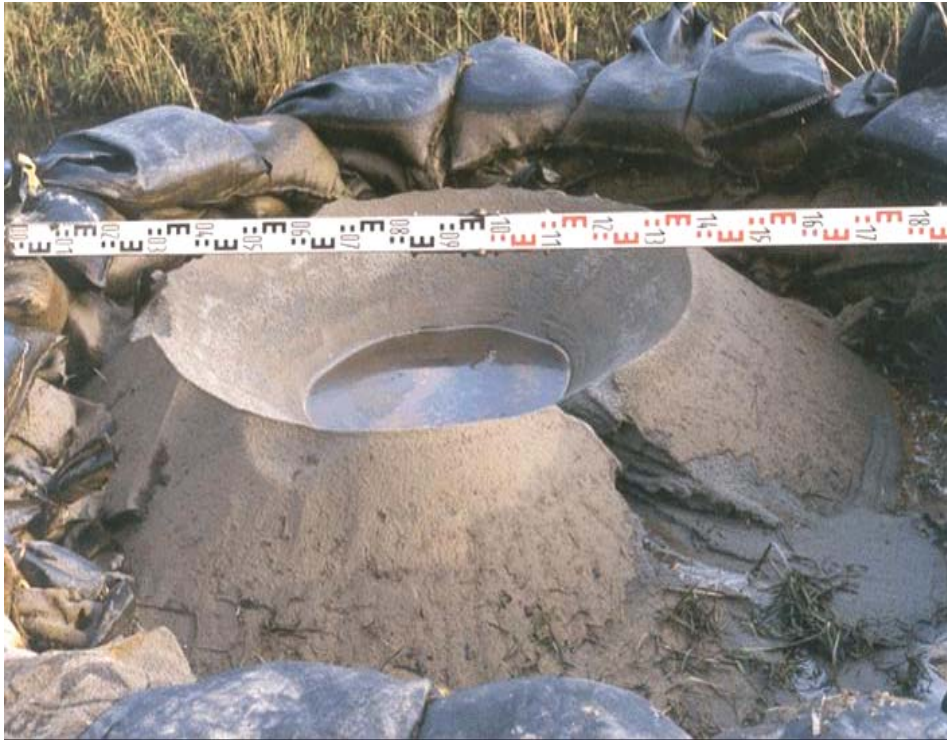
Abbildung 4-19: Quellkalde eines Erosionsgrundbruches in der Natur [Foto: Ministry of Transport, Public Works and Watermanagement, 1995]
