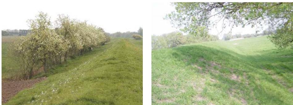
Abbildung 2-26: Baumbewuchs am Deichfuß (links) und Kahlstelle unter einem Baum (rechts) [Fotos: Kokemüller, 2005]
