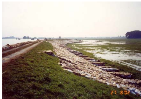
Abbildung 2-10: Durch Sandsäcke stabilisierter Deich mit Erosionsgrundbruch [Foto: Internationale Kommission zum Schutz der Elbe, 2004]
