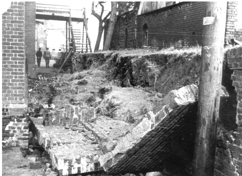
Abbildung 2-28: Deicherosion durch Bauwerk im Deich [Foto: NLWKN, 2005]
