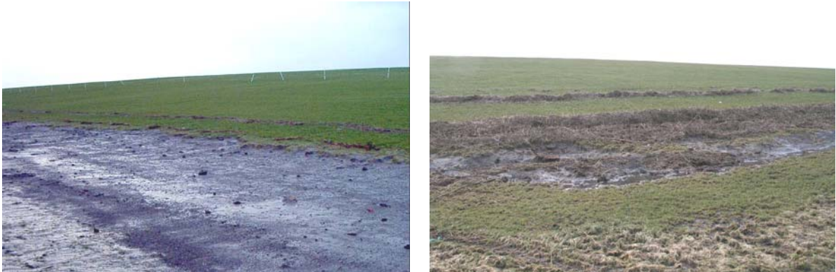
Abbildung 2-24: Kahlstelle (links) und Erosion (rechts) infolge von ungeräumtem Treibsel an einem Deich [Fotos: NLWKN, 2005]
