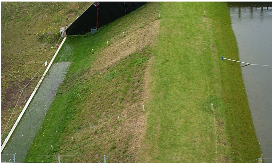
Abbildung 5-29: Ansicht des Deichs nach Beendigung der Versuchsreihe 4 - 09.09.2005 - Niederschlag - komplette Durchsickerung
