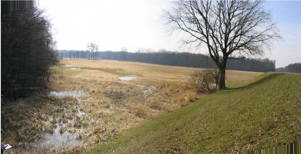
Abbildung 4-24: Durchsickerungen am binnenseitigen Deichfuß
