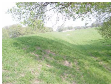
Abbildung 4-42: Gestörte Grasnarbe auf dem Deichkörper infolge Abschattung durch einen Baum
